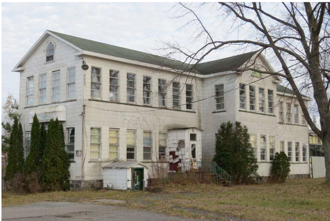
L'ancienne usine de l'AOCO (American Optical Company of Canada Limited), qui a cessé ses activités en 1987. L'édifice offre un très mauvais état physique. 564, rue Martin.
